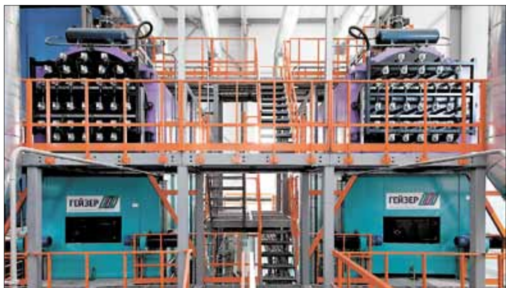
■ Процесс работы обновленной котельной полностью автоматизирован
